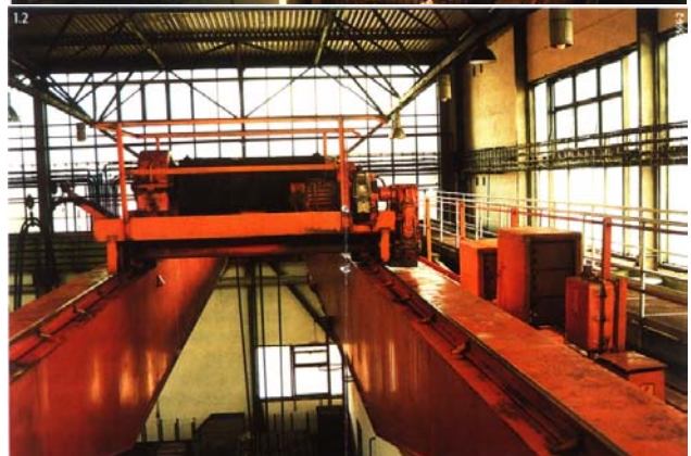
Bild 1 Einblicke in eine brandgasbeaufschlagte Halle nach einem Brand in einer Strahlkabine
