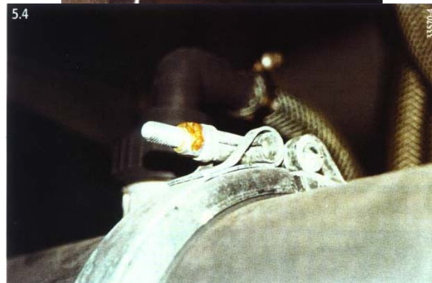
Bild 5 Einige Eindrücke von einer Sickerwasserreinigungsanlage nach Kontaminationen mit konzentrierter Salzsäure
