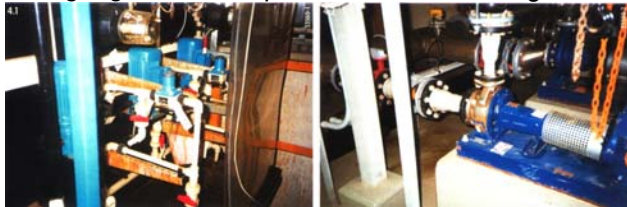
Bild 4 Beispiele deutlicher Korrosion an Teilen der technischen Einrichtung einige Tage nach Beaufschlagung
