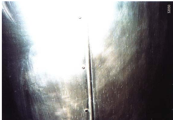
Bild 2 Beispiel der Reinigung von Aluminiumoberflächen - bereits vorhandene lochfraßartige Korrosionen werden dadurch nicht beseitigt
