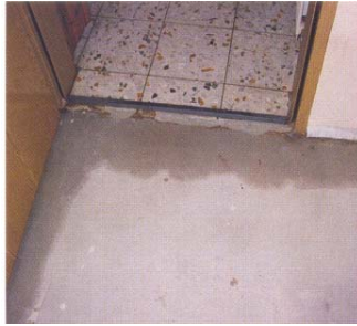
Wasserflecken nach entfernen des Belages
