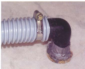
Einblasstutzen für die warme Luft
