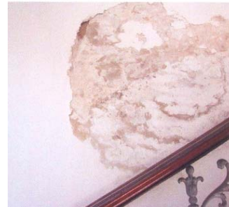
Stiegenhauswand mit typischem Schadensbild
