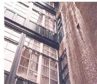
Massiver Wasseraustritt an der Fassade
