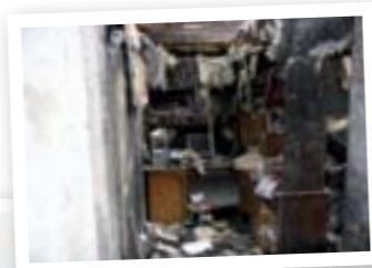
Die ausgebrannten Wohnungen in Steyr waren nach den Löscharbeiten unbewohnbar.
