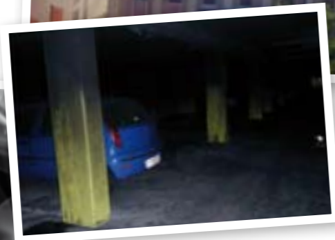
Nach dem Brand in der Innsbrucker Tiefgarage.
